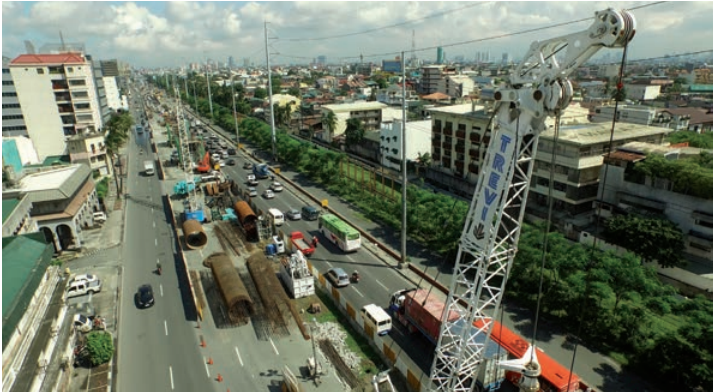
Nelle foto, vista dei cantieri Trevi per la Metro Manila Skyway./In the pictures, view of the Trevi yards for the Metro Manila Skyway.
