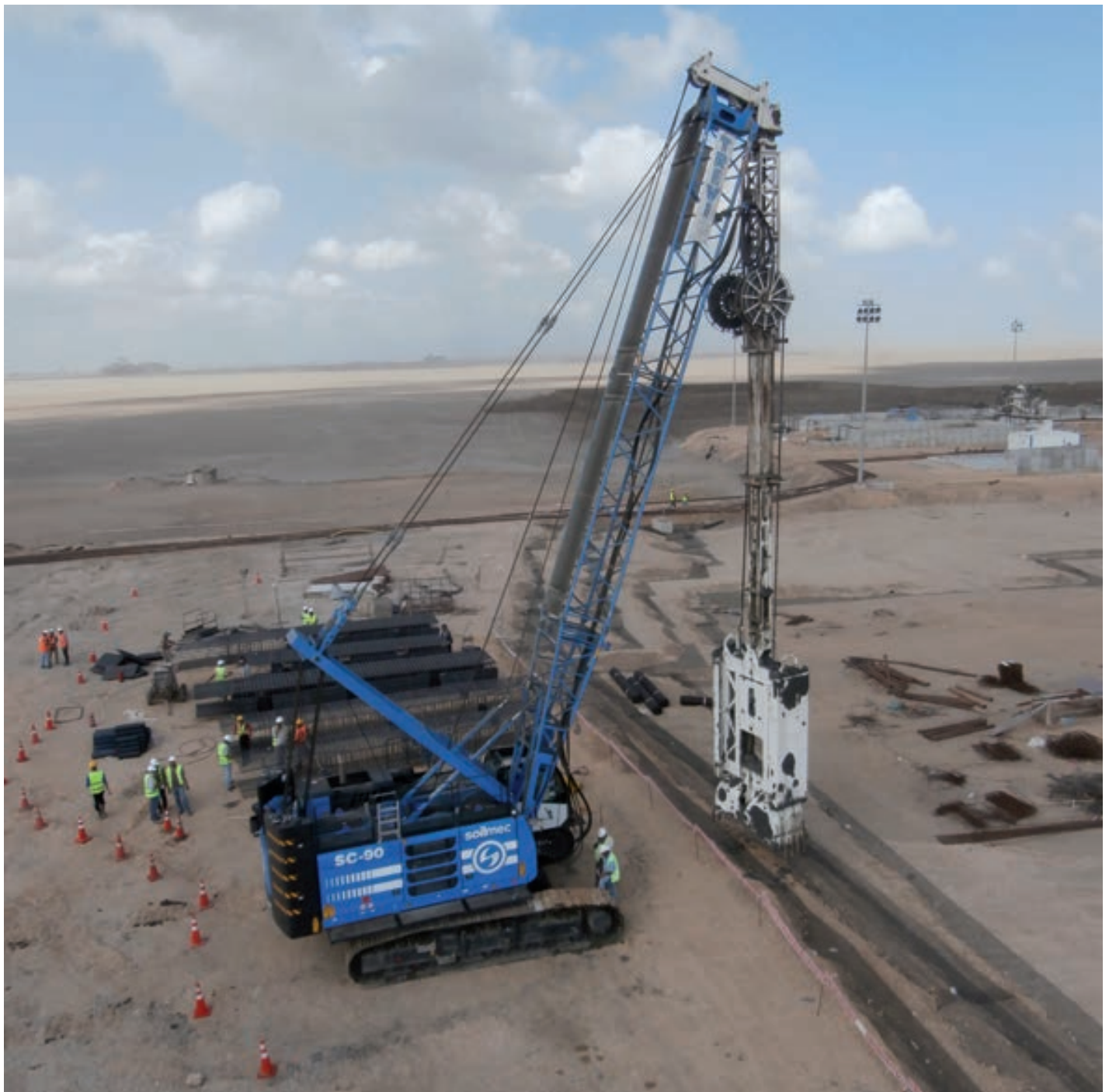
Benna idraulica Soilmec al lavoro per l'espansione del Canale di Suez./Soilmec hydraulic grab at work for the Suez Canal expansion project.
