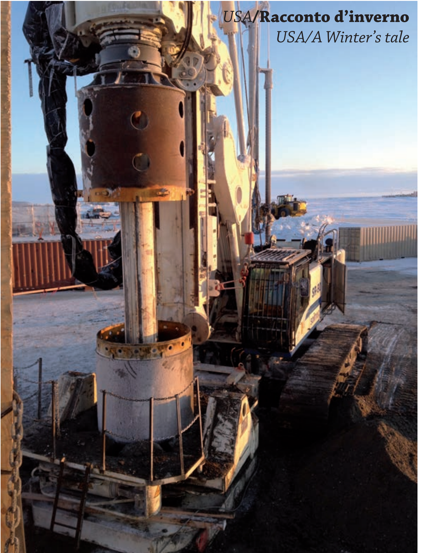
La foto mostra una Soilmec SR-80 al lavoro in Alaska./Photo shows a Soilmec SR-80 at work in Alaska.
