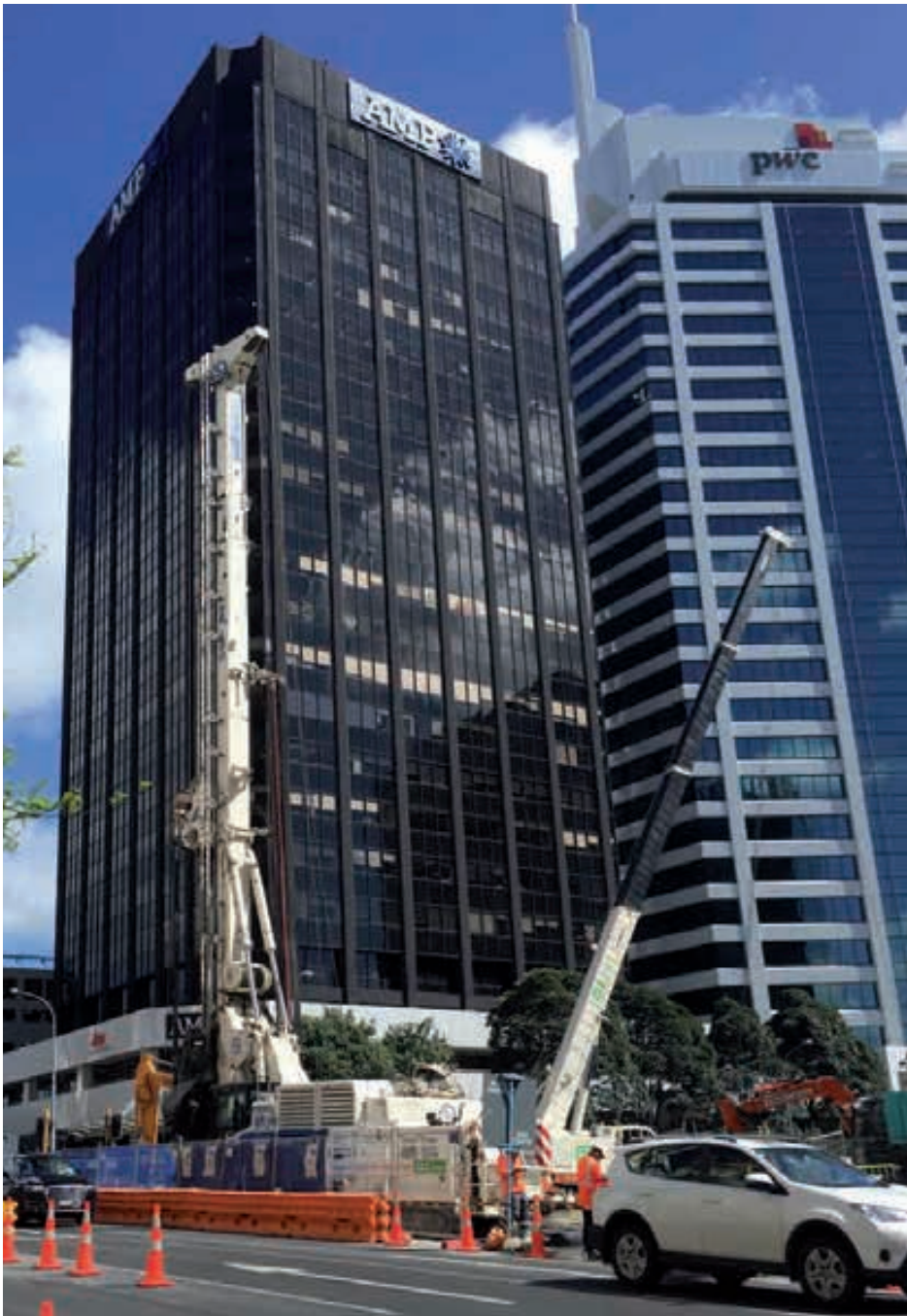
La perforatrice Soilmec SR-100 al lavoro nel centro di Auckland è la prima perforatrice di queste dimensioni all'opera in Nuova Zelanda./The Soilmec SR-100 double rotary drilling rig in action Auckland, the first drilling machine in New Zealand of its size.
