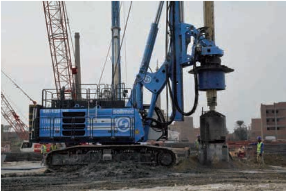
La nuova Soilmec SR-125 è già in cantiere in Egitto. The brand new Soilmec SR-125 is already at works in Egypt.
